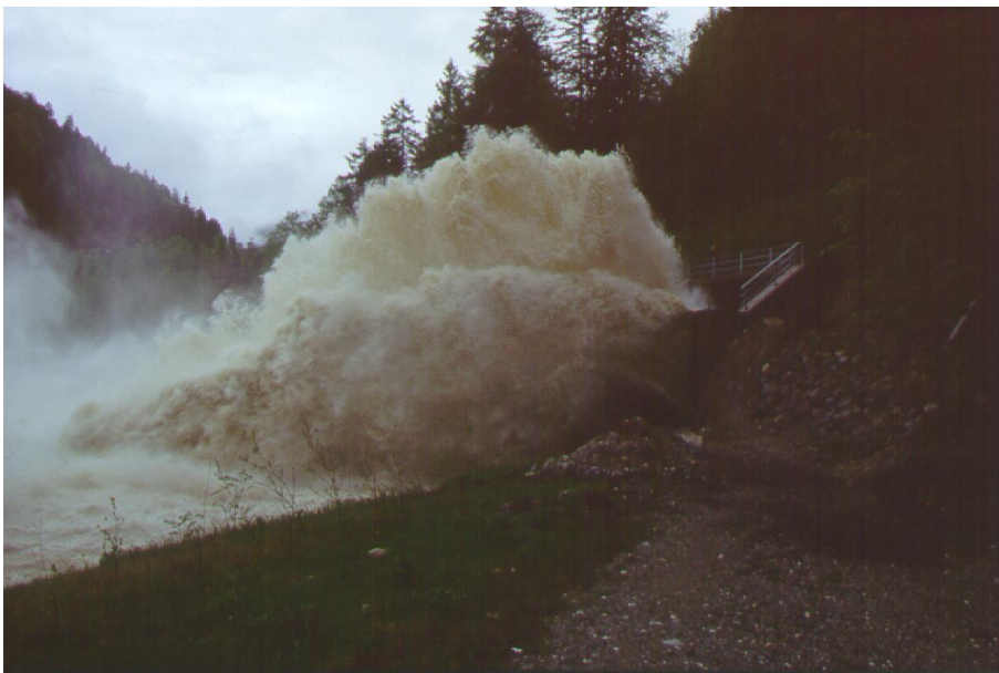
Abb. 9: Auslaufbauwerk der neuen Hochwasserentlastungsanlage in Betrieb
