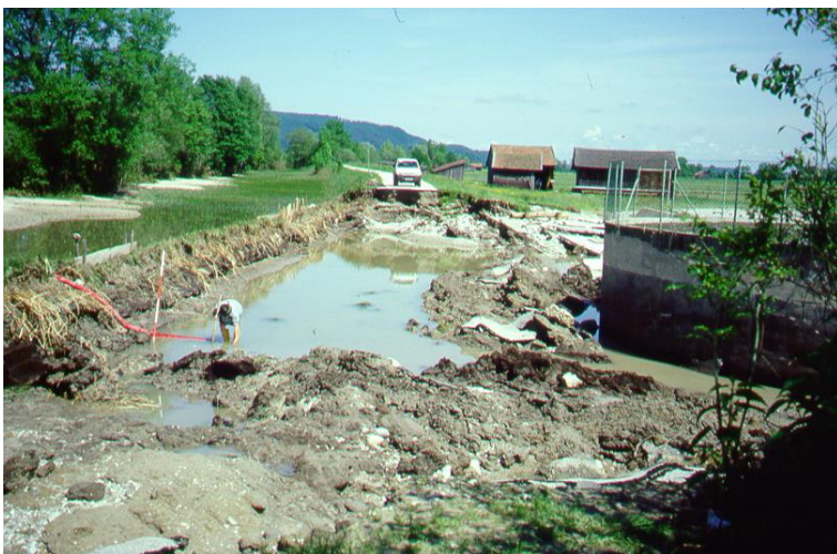
Abb. 21: Deichbruch an der Loisach bei Schlehdorf / Unterrau
