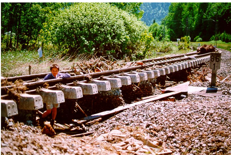
Abb. 29: Hochwasserschäden am Bahnkörper in Eschenlohe
