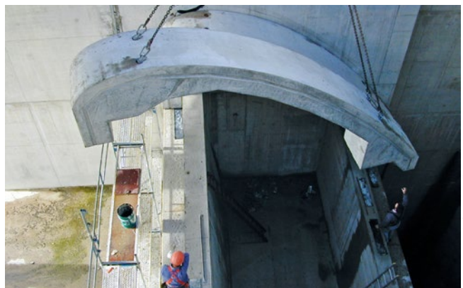
Bild 5: Wiedereinsetzen der einzelnen Segmente der Überfallschwelle an der neuen HWE (nach Erhöhung)
