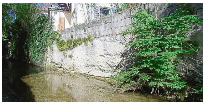
Das Ufermauerwerk ist laut Wasserwirtschaftsamt in einem zum Teil sehr schlechten Zustand.
