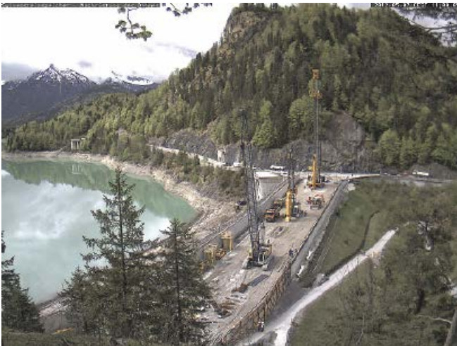
Abb. 3: (Webcam [8]): Schlitzwandarbeiten mit Fräse und Greifer auf der Dammkrone des Sylvensteinspeichers im Sommer 2012, Kronenverbreiterung durch luftseitige Winkelstützmauer, Seabensenkung ca. 5 m
